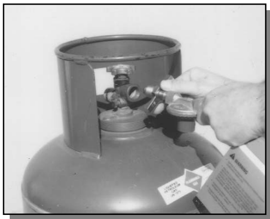
Régulateur avec purgeur orienté vers le sol
